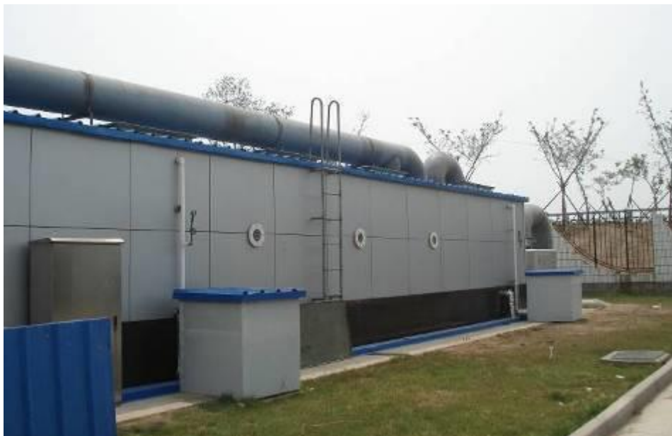
图2.4-1 生物过滤除臭装置
