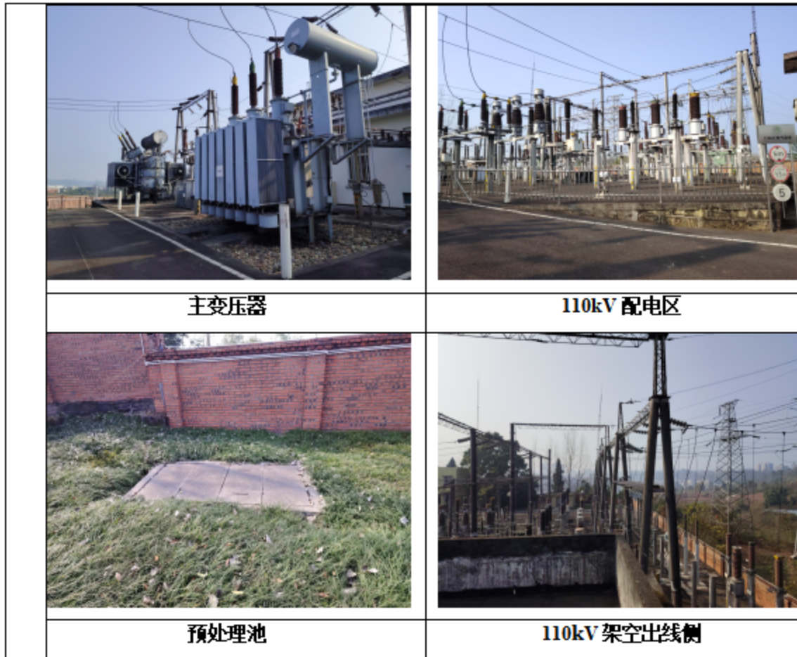
图 3-2 110kV 井研变电站及站内设施现状
