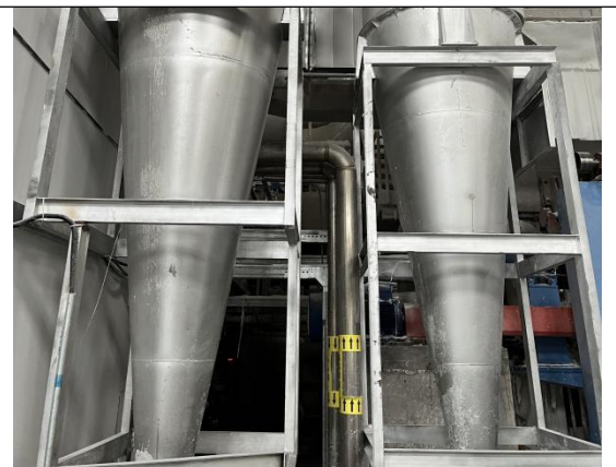
图 2 2#厂区纸机干燥部湿热废气处理系统
