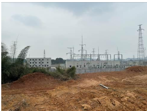
北侧海丰和锐变电站
